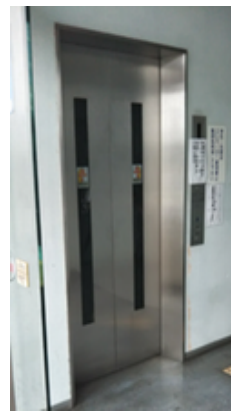
エレベーター
